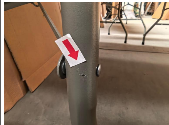
油漆破损-轻微
