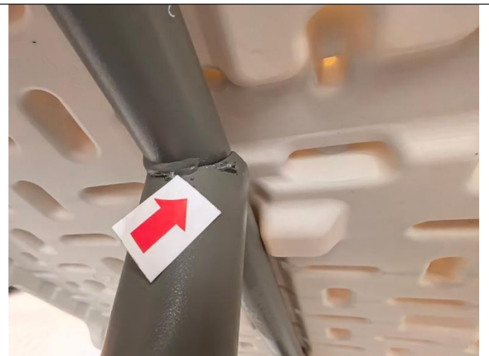
焊道焊接不完整-严重
