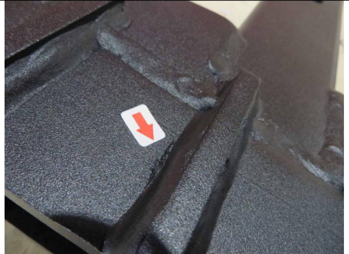
焊缝表面咬边-严重
